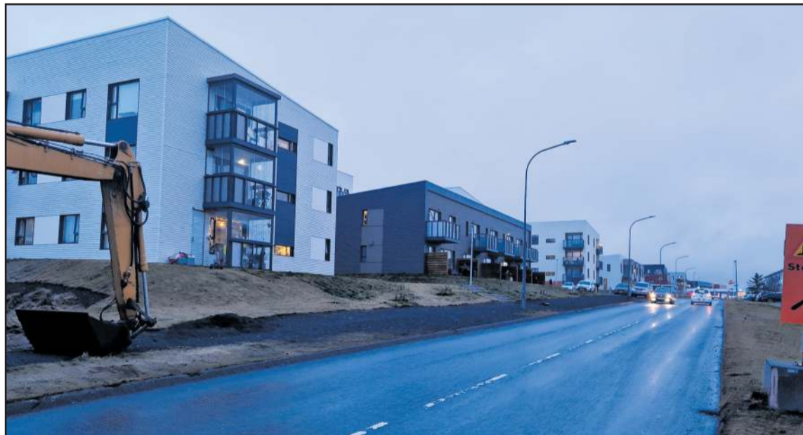
Rúmlega 200 íbúðir hafa verið byggðar á fyrrum æfingarsvæði Fylkis við Hraunbæ. Mikil óánægja er með vanefndir borgarinnar á samningi sem borgarstjóri gerði við Fylki 2017.
